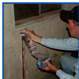
Pukotine u temeljima
