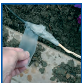
Zaštita podzemnih kabela
